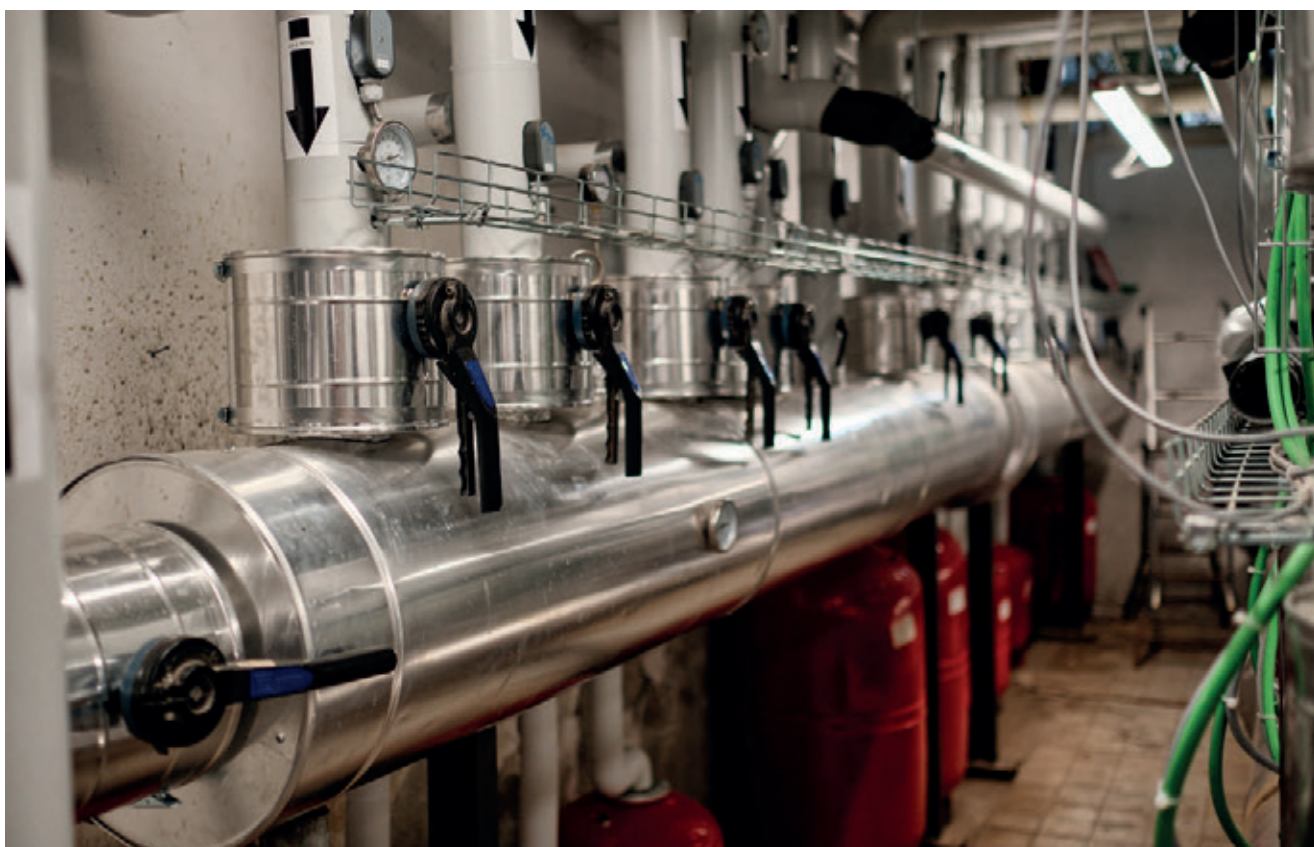
Inverter e centrale termica
