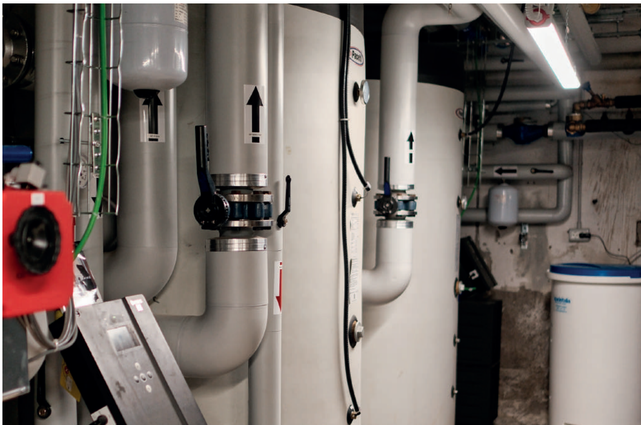
Inverter e centrale termica
